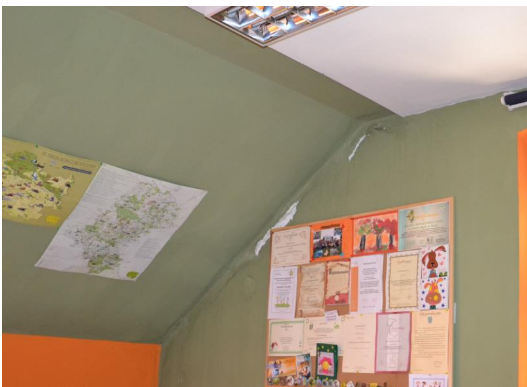
Rys. 47. Przecieki na styku dachu i ściany szczytowej [1.3].
