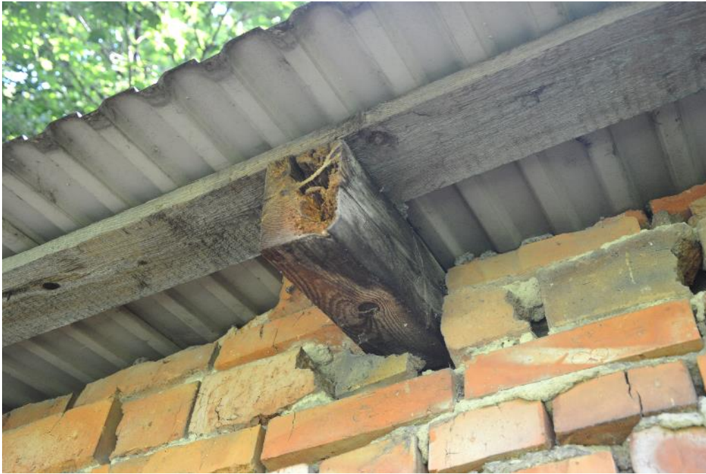
Rys. 52. Krokiew objęta uszkodzeniami [1.3].
