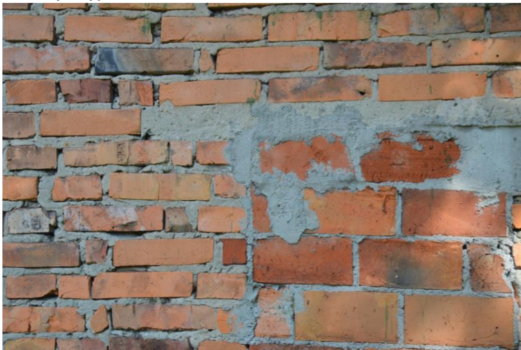
Rys. 48 Niedokładność murowania, niepełne spoiny, zbyt duża grubość spoin, nieestetyczne zamurowania [1.3].
