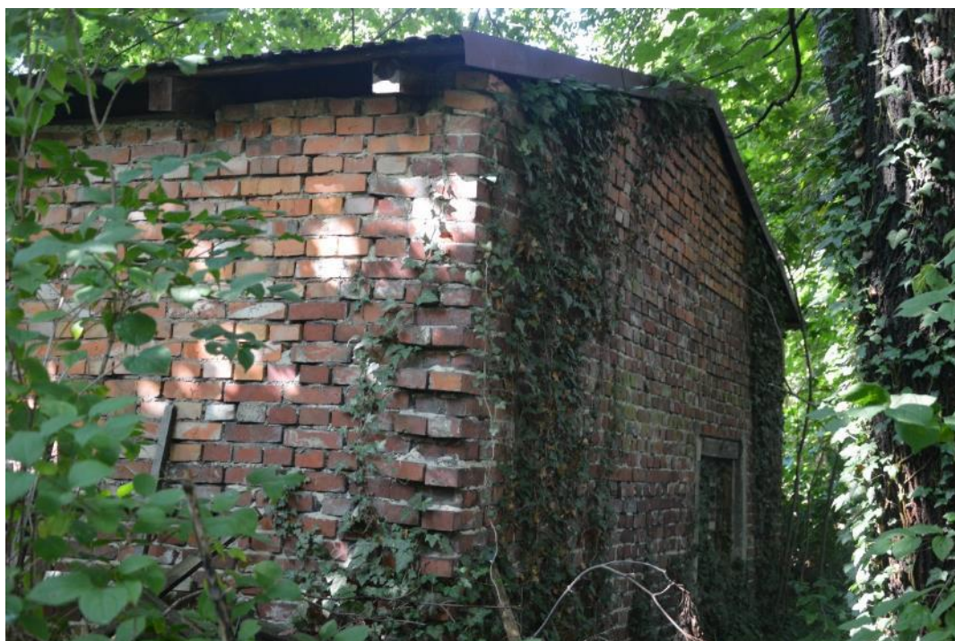
Rys. 49 Niedokładność murowania, niepełne spoiny, brak równości [1.3].
