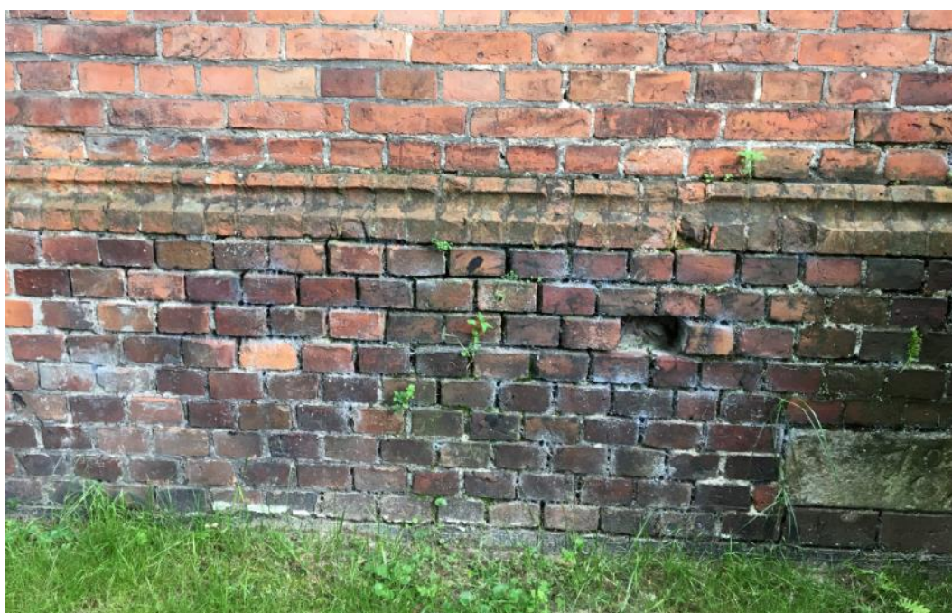
Rys. 33. Wyplukanie spoin, ubytki cegieł, rozwój roślinności w spoinach, wysolenia w strefie cokołowej [1.3].
