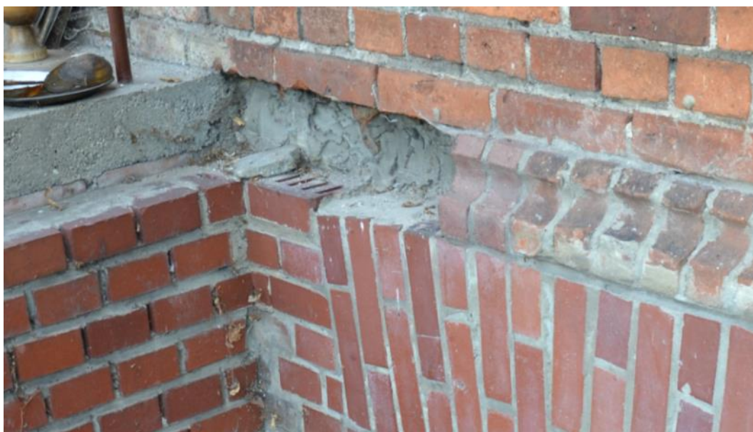
Rys. 45. Brak wykończenia powierzchni bocznej płyty podestu, ubytki gzymsu cokołu przy tylnym wejściu [1.3].
