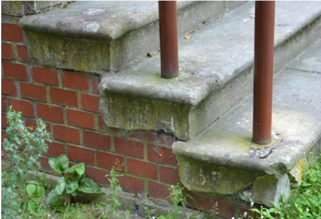
Rys. 38. Spękanne, uszczerbione schody blokowe przed wejściem głównym [1.3].
