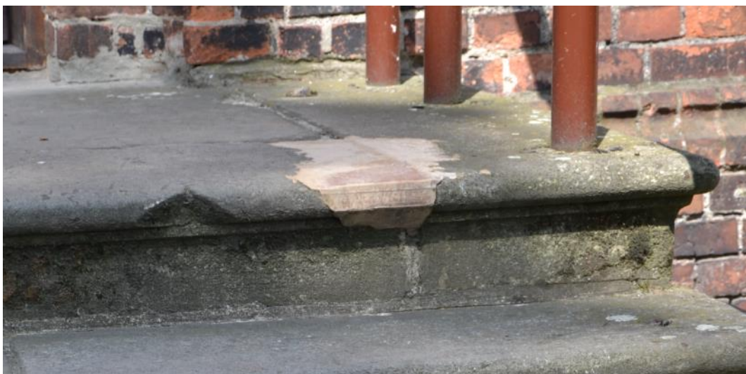
Rys. 39. Ubytki stopni, doraźne nieestetyczne naprawy [1.3].
