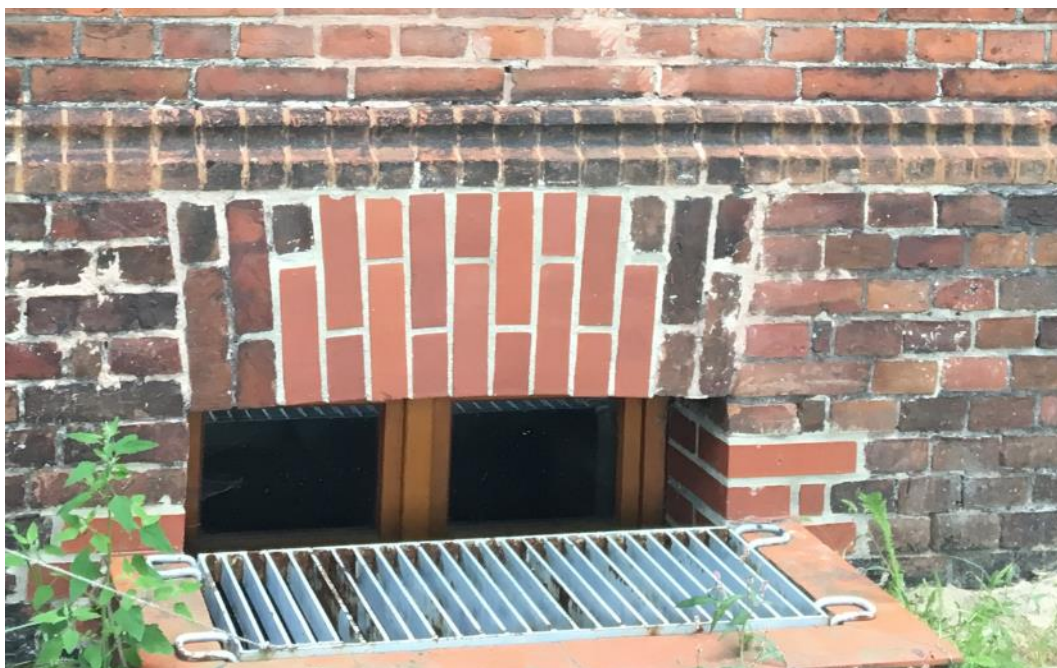
Rys. 31. Brak spójności kolorystycznej uzupełnionych cegieł w nadprożu łukowym okna piwniczego [1.3].
