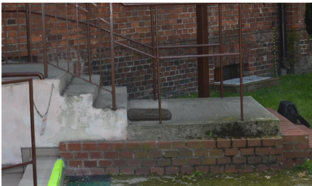
Rys. 44. Złuszczenia powłoki malarskiej, rozwój mikroorganizmów na schodach tylnych [1.3].
