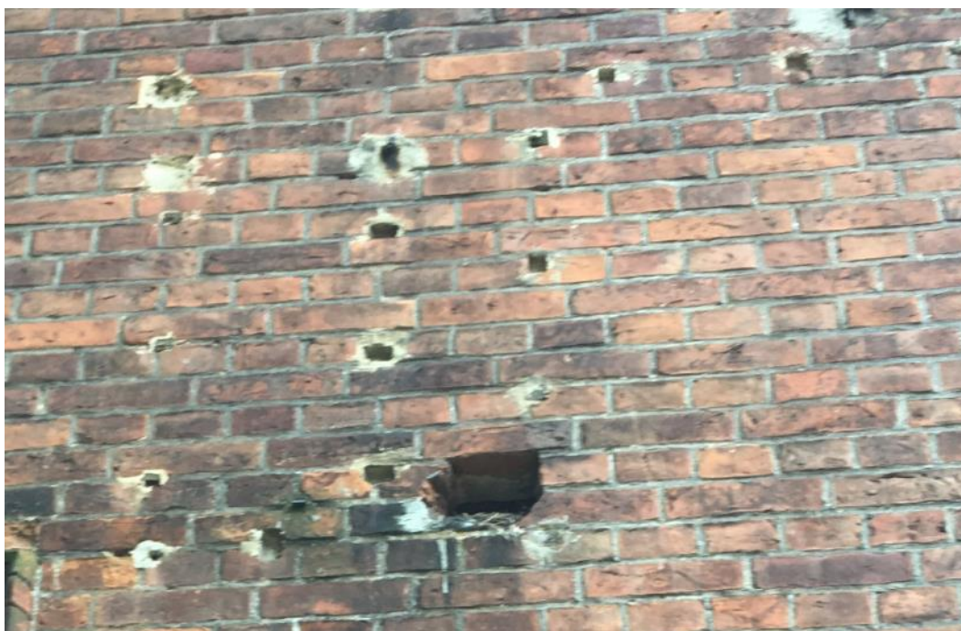
Rys. 36. Ubytki cegieł, zabrudzenia, pozostałości po mocowaniach na elewacji [1.3].
