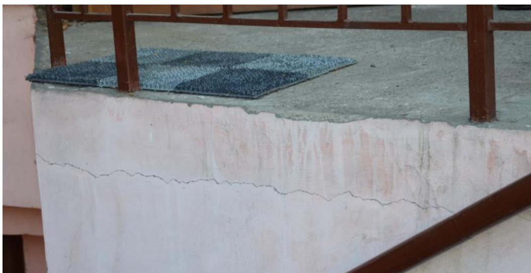
Rys. 46. Zarysowanie na styku płyty podestu i muru – tylne wejście do budynku [1.3].
