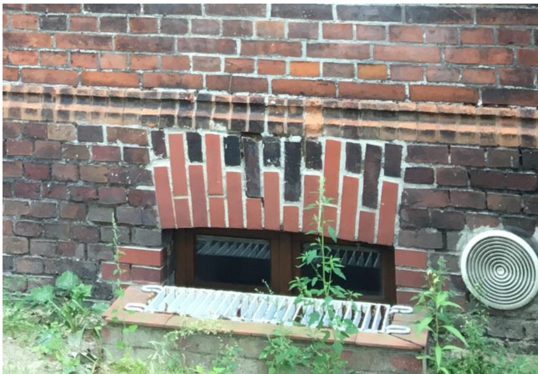
Rys. 30. Brak spójności kolorystycznej uzupełnionych cegieł w nadprożu łukowym okna piwniczego [1.3].
