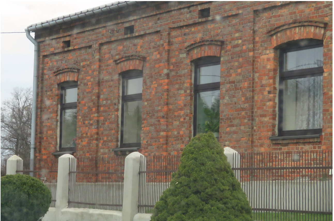
104. Konopiska, plebania (otulina) – wymienione okna
