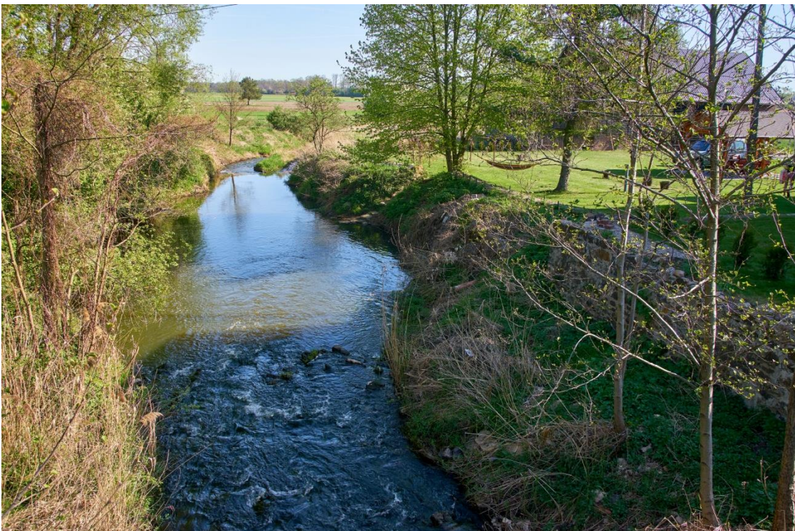
Fot. 24. Pozostałości piętrzenia w korycie Potoku Jeżowskiego w miejscowości Panoszów (stan: maj 2018) (fot. J. Suchożebrski)
