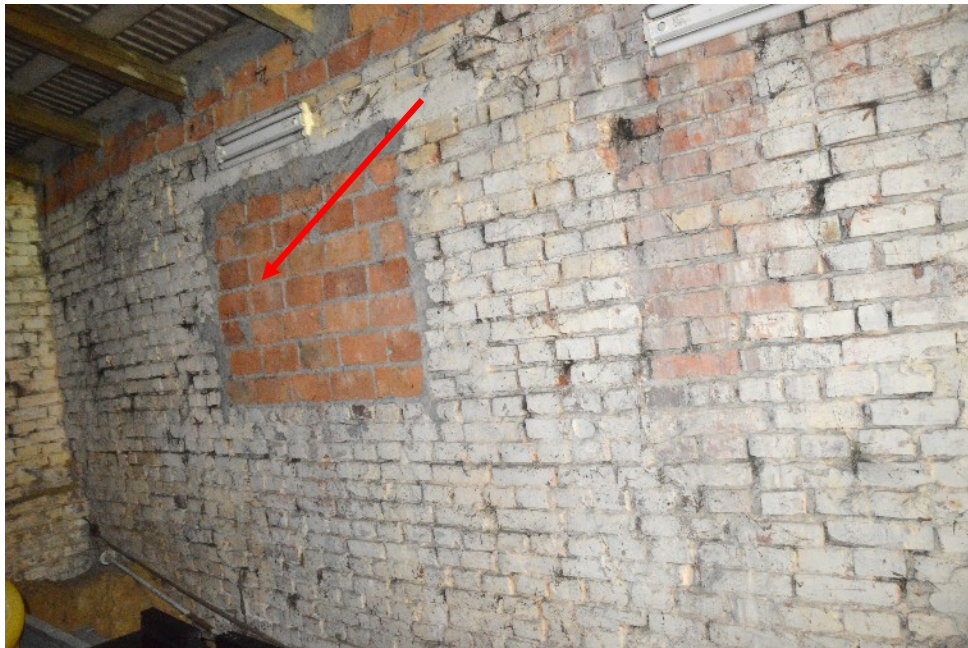
Rys. Zabrudzenia ścian, widoczna niedokładność wykonania muru [1.3].
