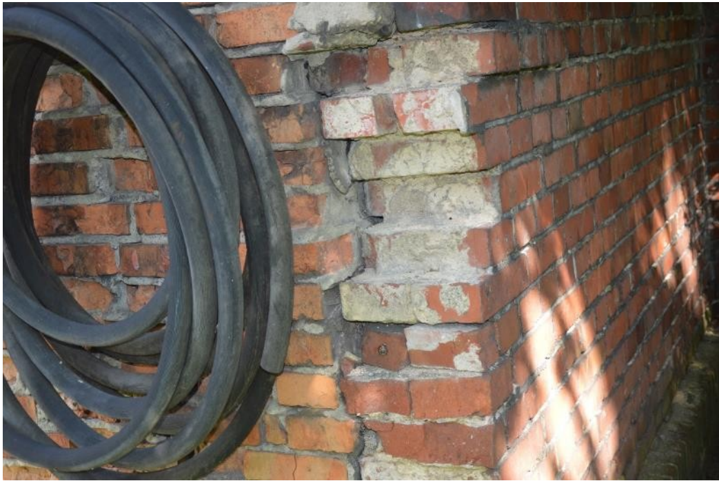
Rys. Brak przewiązania ścian prostopadłych [1.3].
