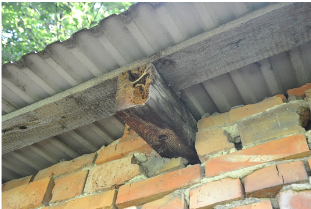
Rys. Krokiew objęta uszkodzeniami [1.3].
