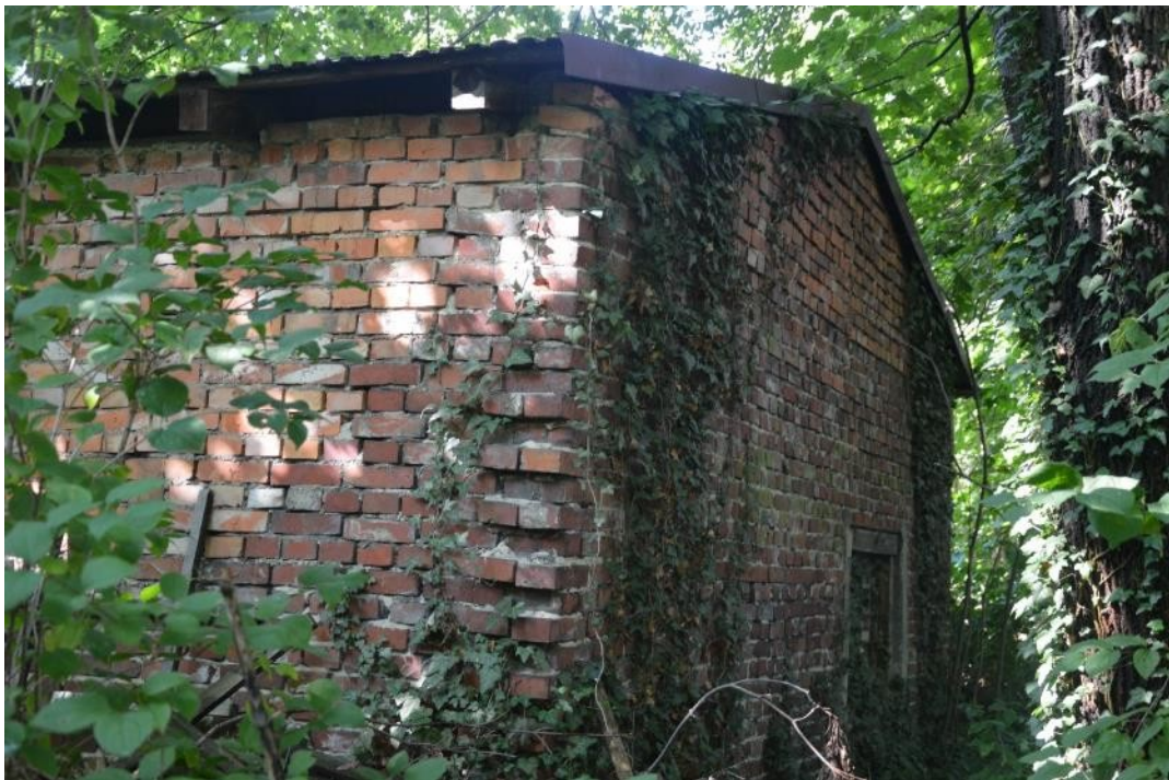
Rys. Niedokładność murowania, niepełne spoiny, brak równości [1.3].
