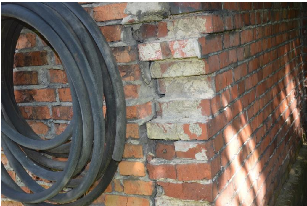
Rys. Brak przewiązania ścian prostopadłych [1.3].
