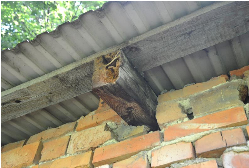
Rys. Krokiew objęta uszkodzeniami [1.3].
