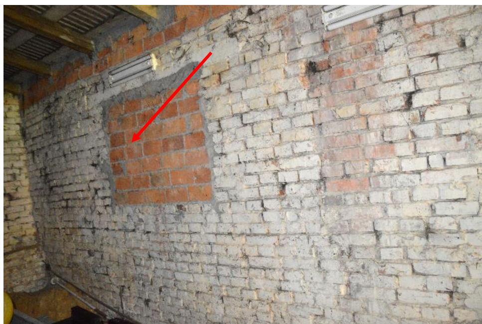
Rys. Zabrudzenia ścian, widoczna niedokładność wykonania muru [1.3].
