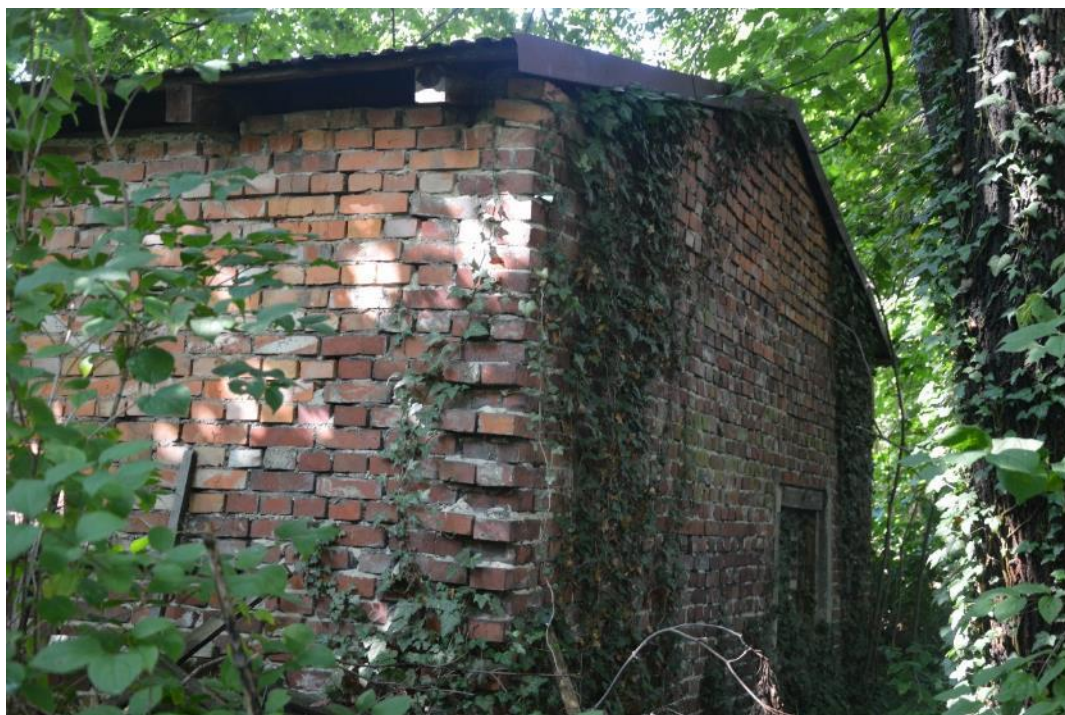
Rys. Niedokładność murowania, niepełne spoiny, brak równości [1.3].
