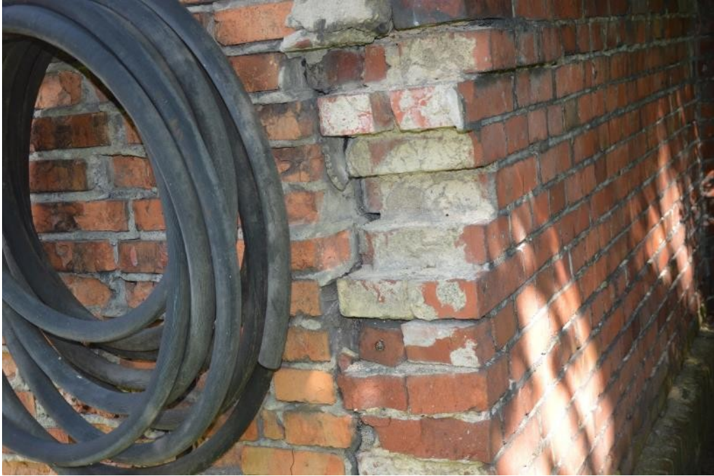
Rys. Brak przewiązania ścian prostopadłych [1.3].
