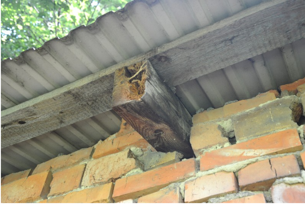
Rys. Krokiew objęta uszkodzeniami [1.3].
