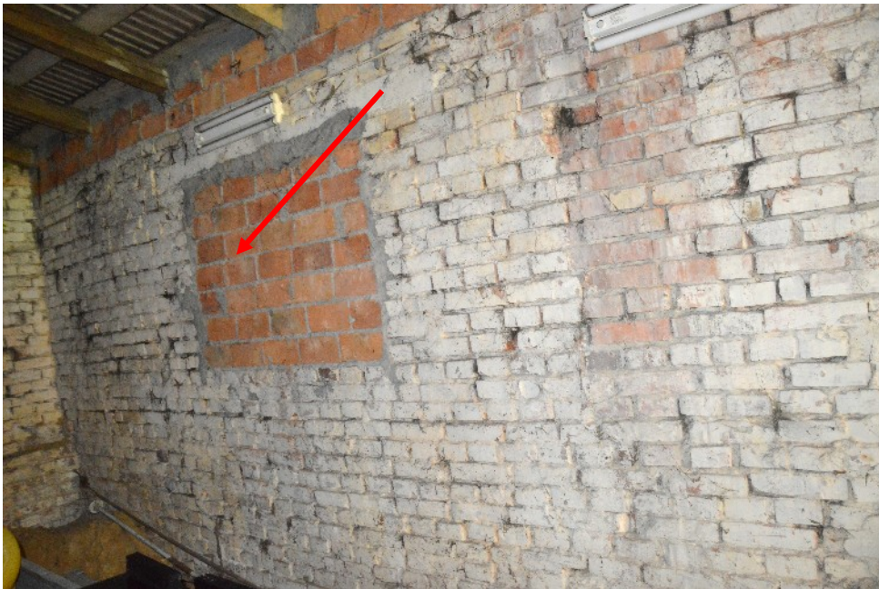
Rys. Zabrudzenia ścian, widoczna niedokładność wykonania muru [1.3].
