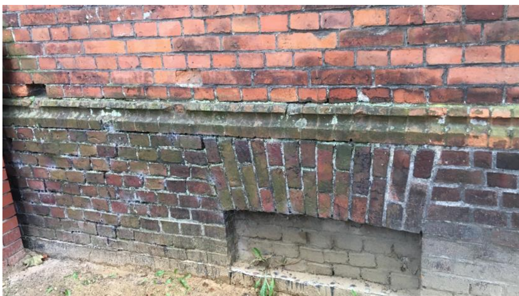
Rys. 37. Wypłukanie spoin, ubytki cegieł, rozwój roślinności w spoinach, wysolenia w strefie cokołowej [1.3].
