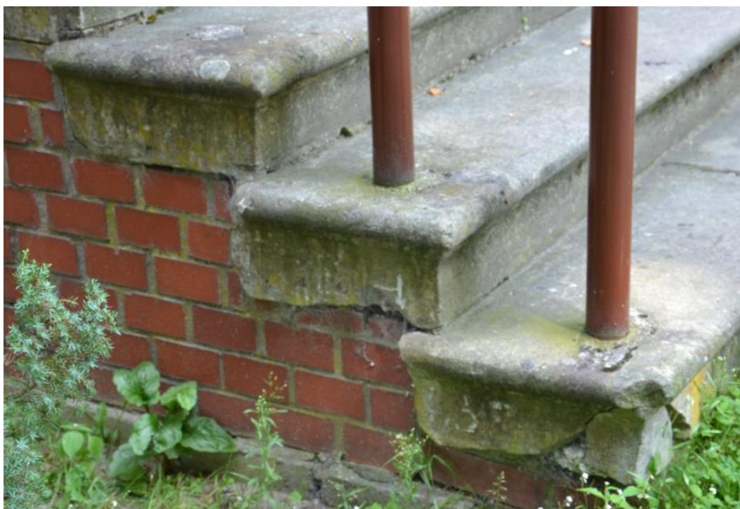
Rys. 38. Spękanne, uszczerbione schody blokowe przed wejściem głównym [1.3].
