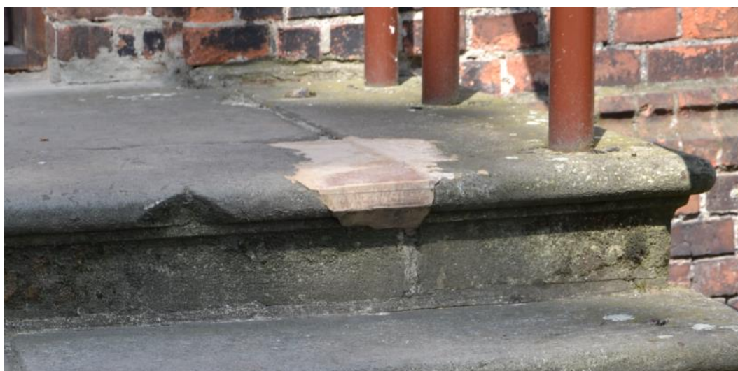
Rys. 39. Ubytki stopni, doraźne nieestetyczne naprawy [1.3].
