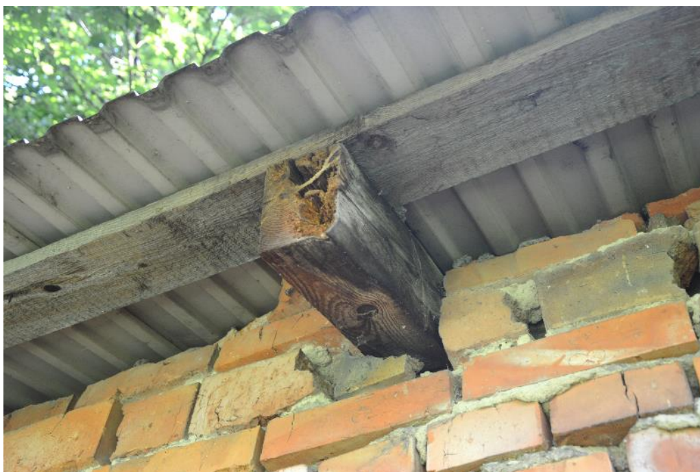
Rys. 52. Krokiew objęta uszkodzeniami [1.3].
