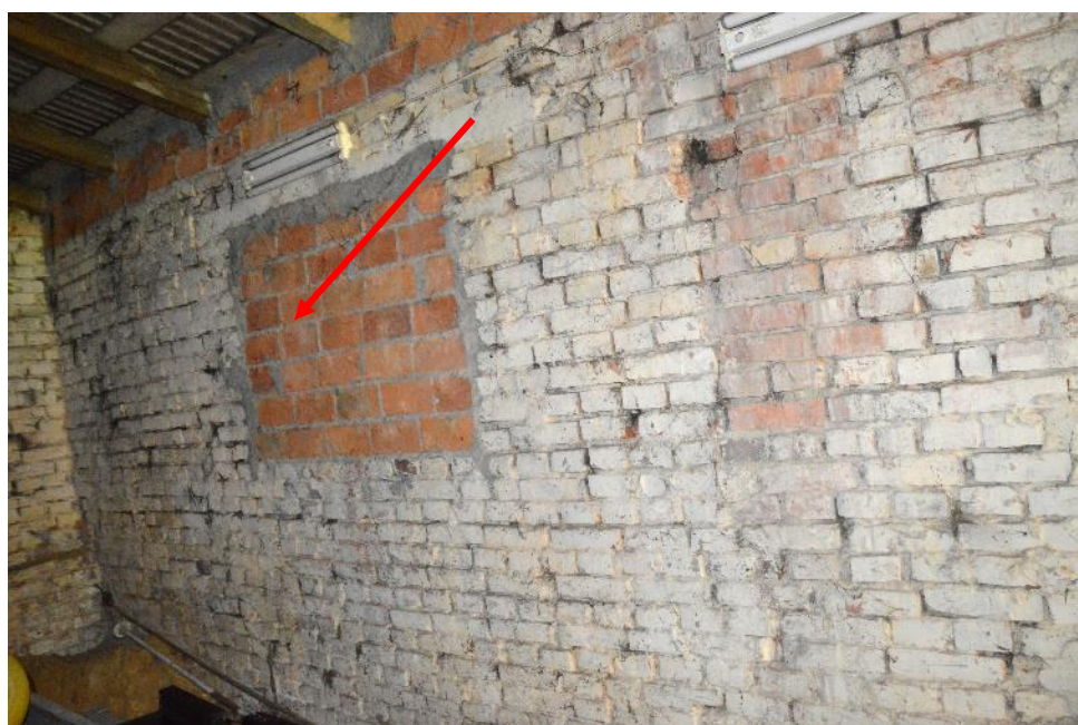
Rys. 51 Zabrudzenia ścian, widoczna niedokładność wykonania muru [1.3].
