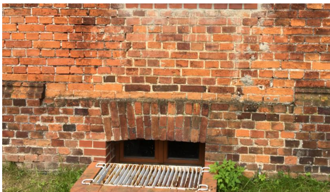
Rys. 35. Wypłukanie spoin, ubytki cegieł gzymsu cokołowego [1.3].
