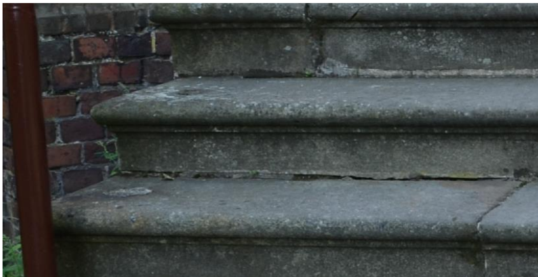
Rys. 40. Wypłukane spoiny, zabrudzenia, nierówności schodów przed wejściem głównym [1.3].
