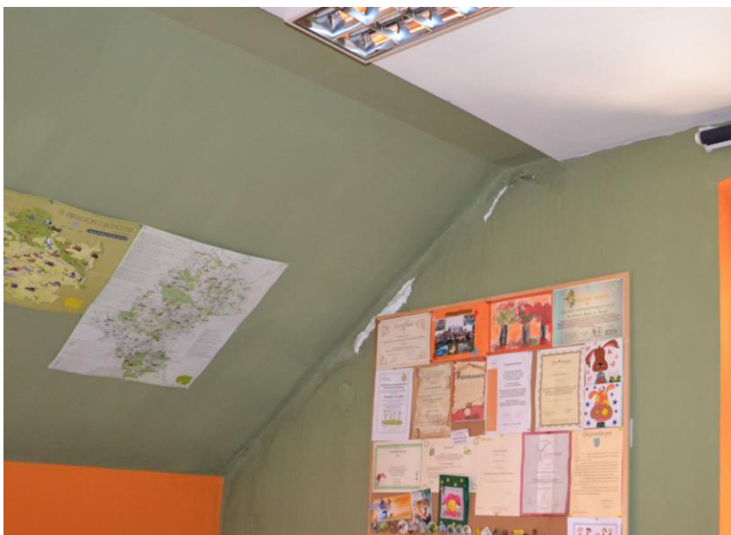
Rys. 47. Przecieki na styku dachu i ściany szczytowej [1.3].
