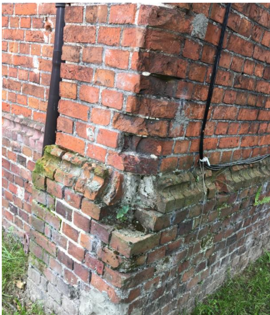
Rys. 34. Wypłukanie spoin, ubytki cegieł, rozwój roślinności w spoinach, wysolenia w strefie cokołowej; ubytki cegieł na narożniku budynku [1.3].
