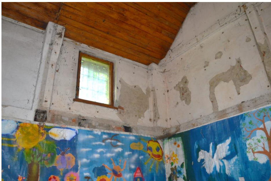
Rys. 12 Spękania tynków, zabrudzenia, nieestetyczne wykończenia powierzchni [1.3]
