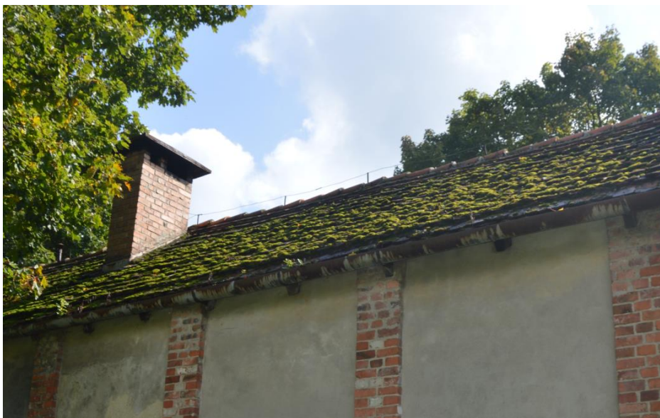
Rys. 15. Rozwój mikroorganizmów na powierzchni dachu, korozja rynien [1.3]
