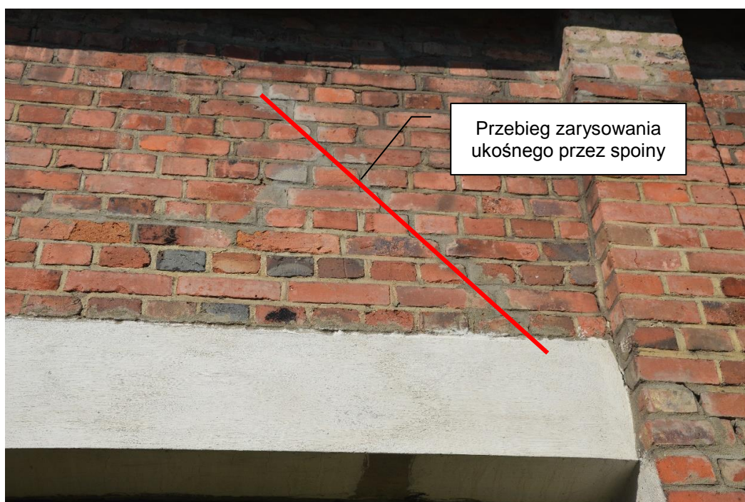
Rys. 10 Zarysowanie muru nad otworem drzwiowym [1.3]
