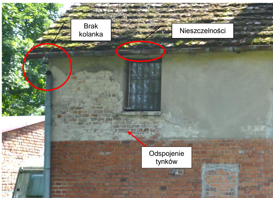
Rys. 8 Odspojenie tynków zewnętrznych, brak połączeń rur spustowych [1.3]
